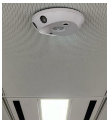
西九龙政府合署控制照明感应器
