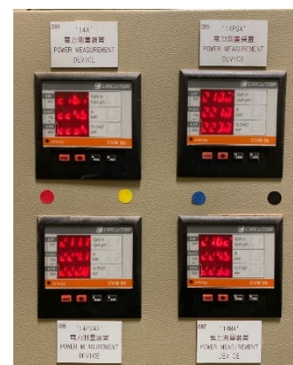
海港政府大楼监察局部用电量的独立电表
