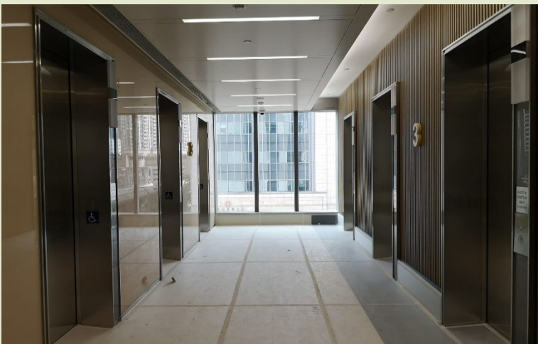
库务大楼的电力再生功能升降机
