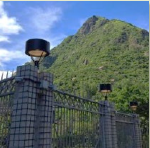
顺利纪律部队宿舍的太阳能街灯
