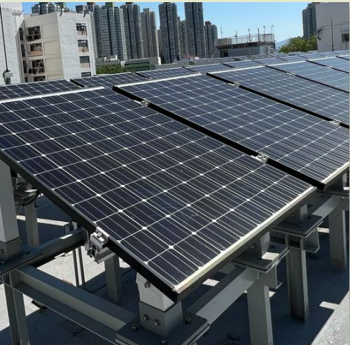
大埔政府合署的太阳能光伏板系统
