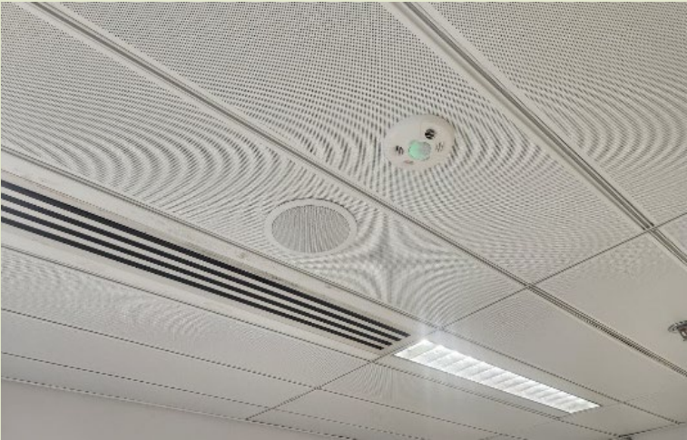
工业贸易大楼的控制照明感应器
