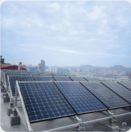
北角政府合署的太阳能光伏板系统
