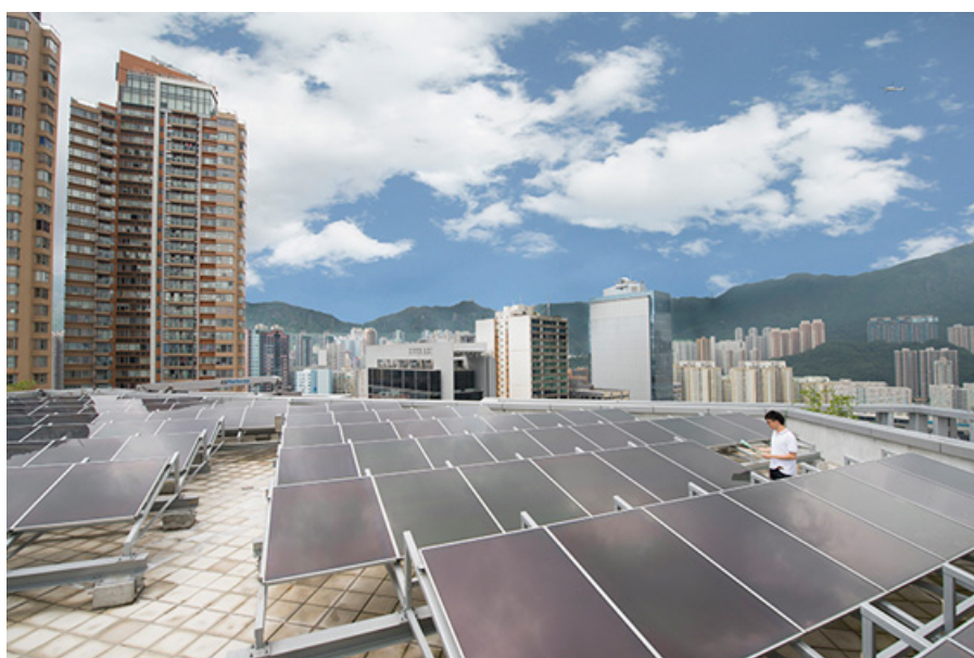
在工業貿易大樓安裝的光伏板
