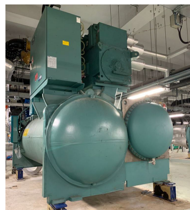
港珠澳大橋香港口岸的海水製冷機
