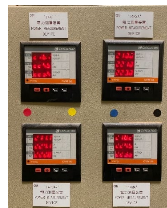
海港政府大樓監察局部用電量的獨立電錶
