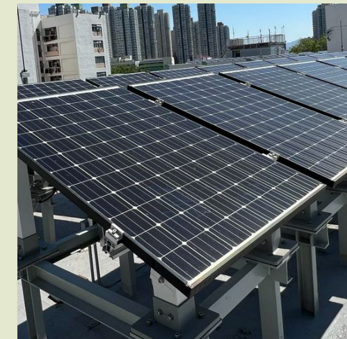
大埔政府合署的太陽能光伏板系統
