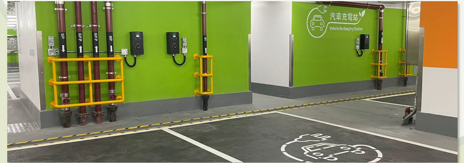
庫務大樓停車場的電動車充電器
