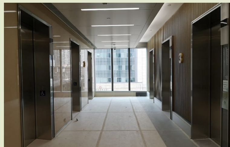
庫務大樓的電力再生功能升降機
