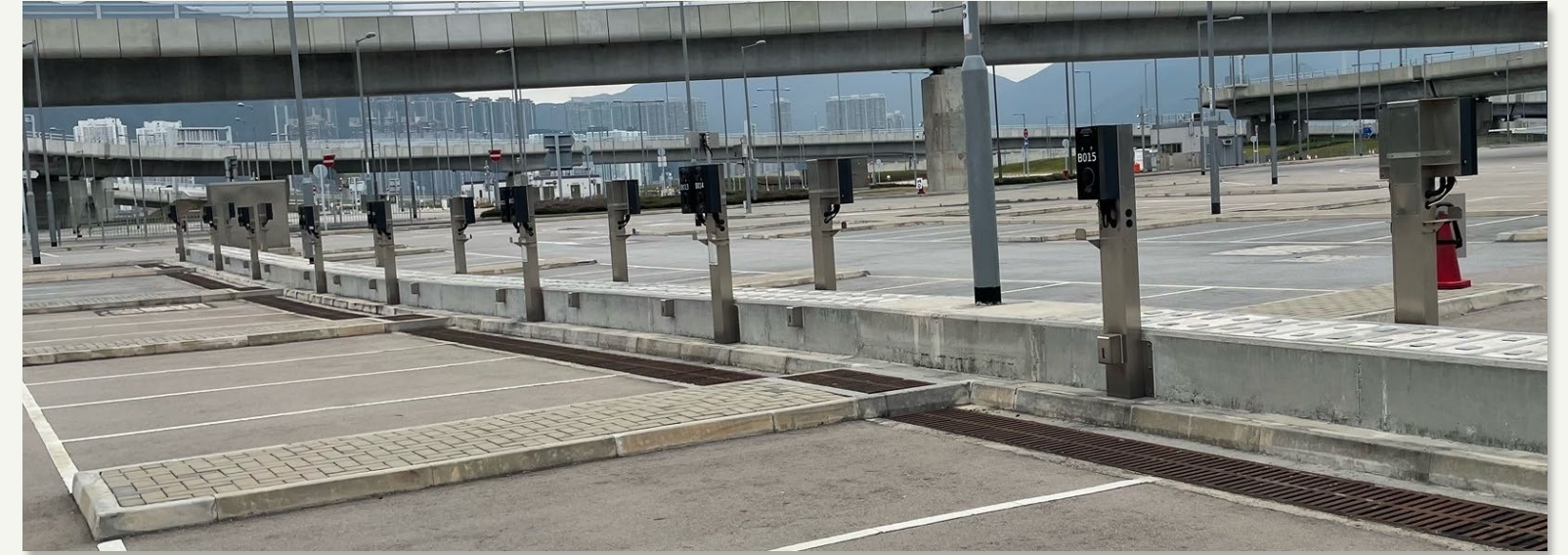
港珠澳大橋香港口岸公眾停車場的電動車充電器
