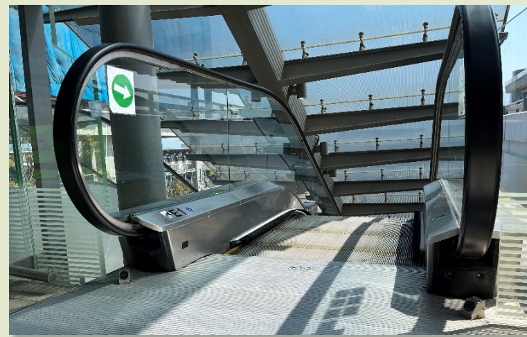
港珠澳大橋香港口岸按需求服務的自動梯
