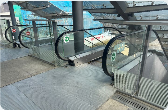
港珠澳大橋香港口岸按需求服務的自動梯
